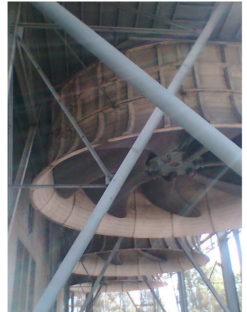
Les ventilateurs des tours de refroidissement
